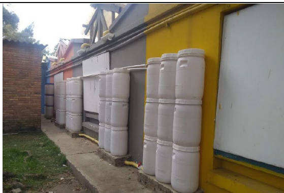
Módulos de almacenamiento de aguas lluvia Unidad de Cuidado Animal
